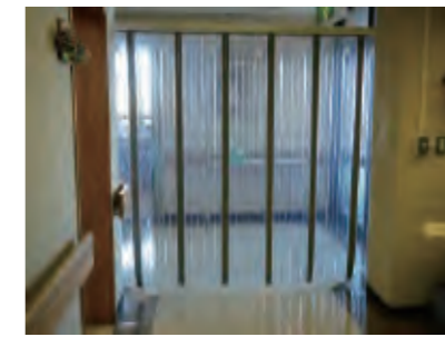
愛知県 病院通路 一般防災静電リブ
