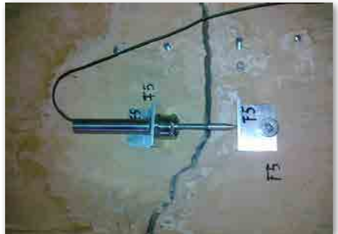
教会の地下壁の亀裂を監視する
