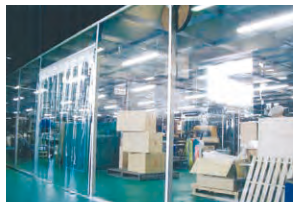
保管庫ビニールブース
