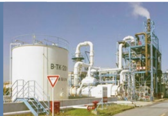
塩酸回収設備
